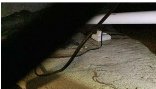
Løs stikkontakt i kjeller.
