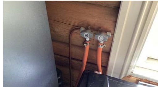
Koblingspunkter på kjøkken.
