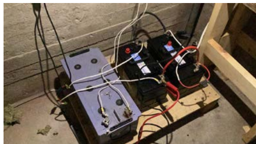
Batteripakke i kjeller.
