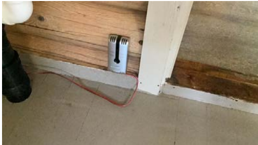
Lekkasjevakt på kjøkken.
