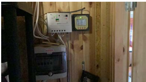
Sikringer og bryterpanel i bod.
