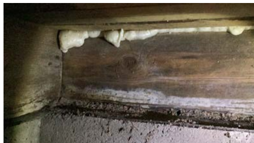
Det er stedvis tegn til at det har vært fuktpåkjenninger på bjelker.
