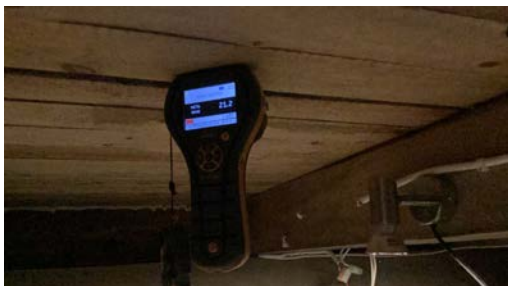
Fuktmåling i kjeller på ca. 21 vektprosent.
