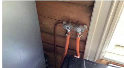
Koblingspunkter på kjøkken.
