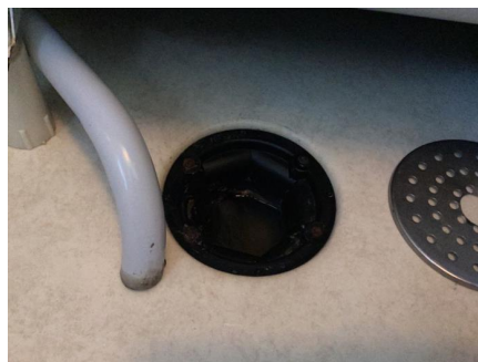
Sluk av plast med klemring.
