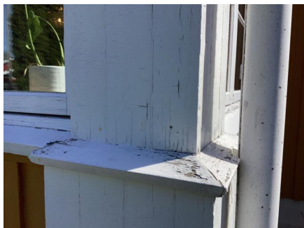
Eksempel på slitasje på hjørnekasse.
