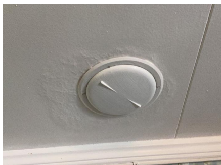
Svelling i himling ved ventil.
