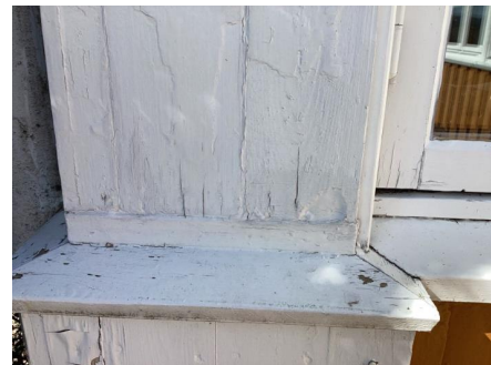
Hjørnekasse med råteskade som er fylt med fugemasse.
