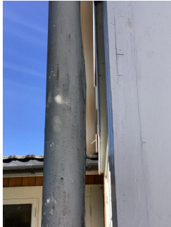
Eksempel på taknedløp med frostspreng.
