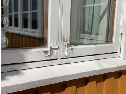
Eksempel på utvendig slitasje.
