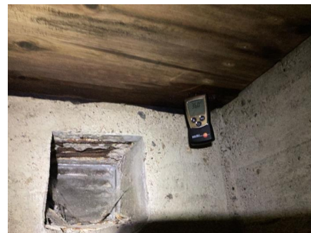
Området med misfarging i himling og høyt fuktinnhold.
