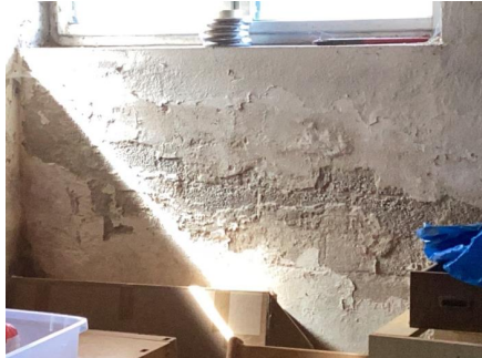
Eksempel på avskaling på vegger.
