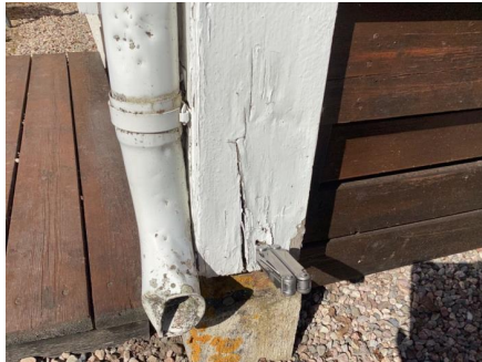
Råte i kledningsbord rundt søyle.
