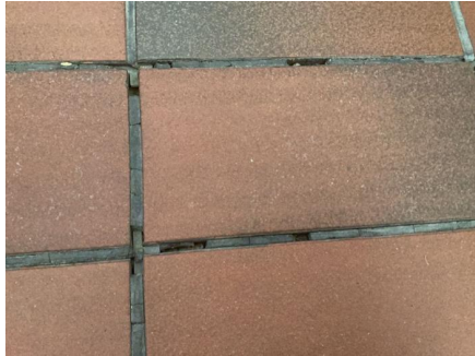
Oppsprekking i fuger kjøkkenentre.
