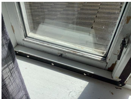
Eksempel på innvendig slitasje.
