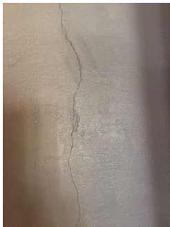
Sprekk i overflate på pipe i 2. etasje.
