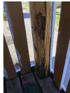
Eksempel på råte i rekkverk på balkong.
