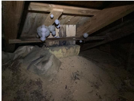
Rennemerker rundt gjennomføring for lufting på loft.
