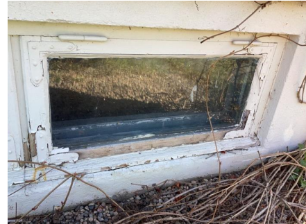
Eksempel på slitasje på kjellervindu.
