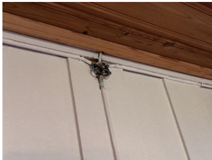
Koblingsboks uten lokk.
