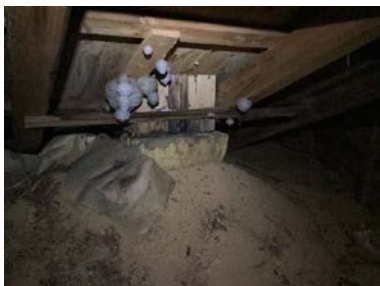
Rennemerker rundt gjennomføring for lufting på loft.
