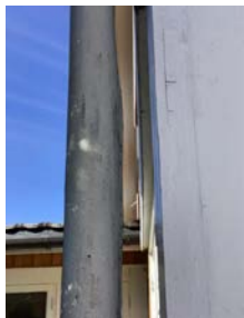
Eksempel på taknedløp med frostspreng.
