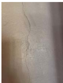
Sprekk i overflate på pipe i 2. etasje.
