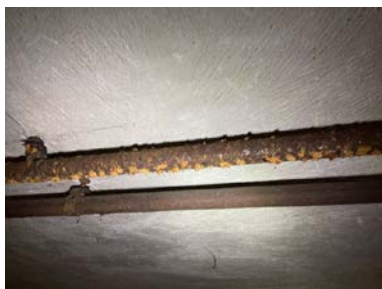
Eksempel på rust på vannrør.
