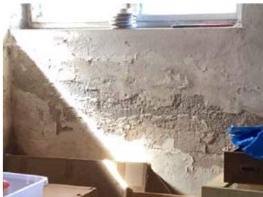
Eksempel på avskaling på vegger.
