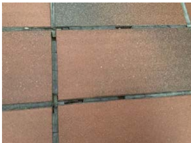
Oppsprekking i fuger kjøkkenentre.
