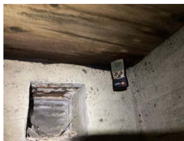
Området med misfarging i himling og høyt fuktinnhold.
