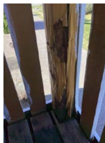
Eksempel på råte i rekkverk på balkong.
