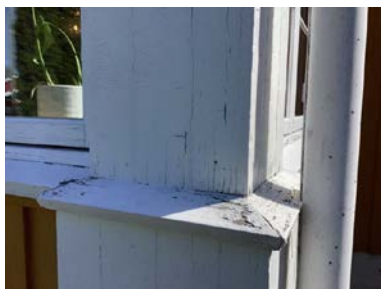
Eksempel på slitasje på hjørnekaske.
