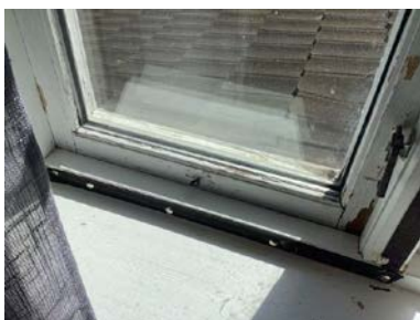
Eksempel på innvendig slitasje.
