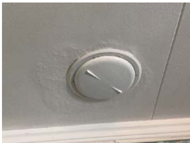
Svelling i himling ved ventil.
