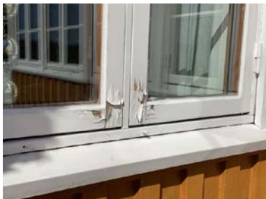
Eksempel på utvendig slitasje.
