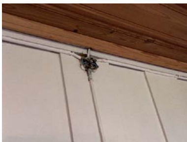
Koblingsboks uten lokk.
