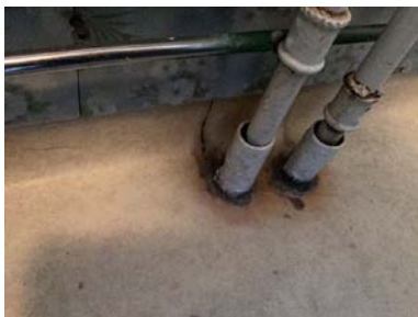
Utett ved gjennomføring i gulv.
