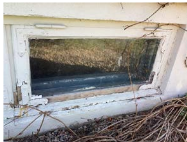
Eksempel på slitasje på kjellervindu.
