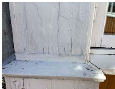
Hjørnekaske med råteskade som er fylt med fugemasse.
