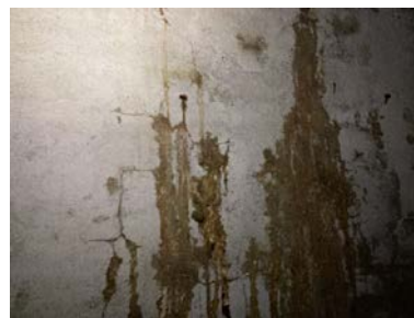
Eksempel på sprekker og rennemerker på pipe på loft.
