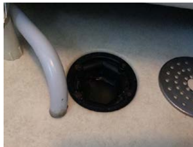
Sluk av plast med klemring.
