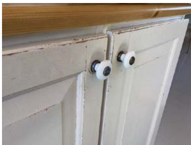
Eksempel på slitasje.
