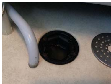
Sluk av plast med klemring.
