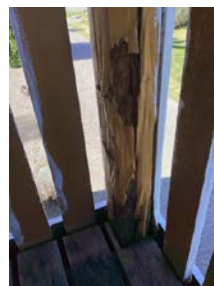
Eksempel på råte i rekkverk på balkong.
