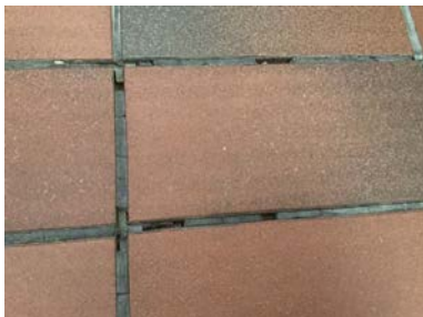
Oppsprekking i fuger kjøkkenentre.
