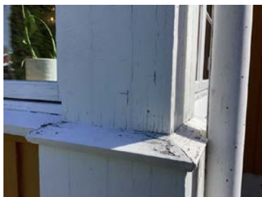
Eksempel på slitasje på hjørnekaske.
