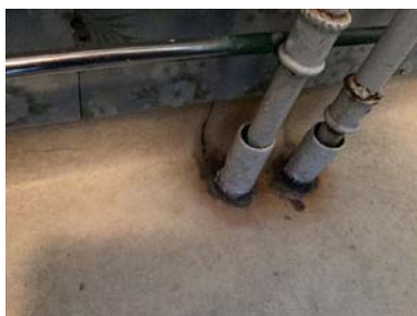
Utett ved gjennomføring i gulv.
