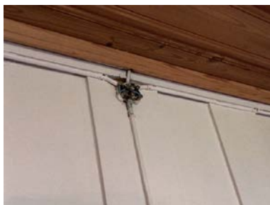
Koblingsboks uten lokk.
