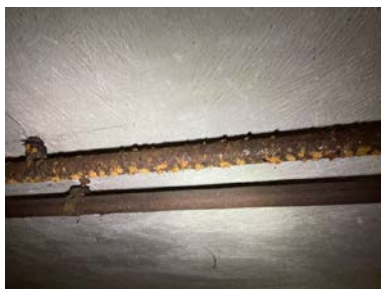
Eksempel på rust på vannrør.
