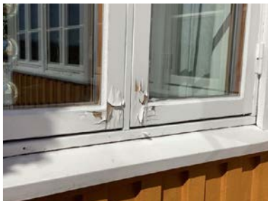
Eksempel på utvendig slitasje.
