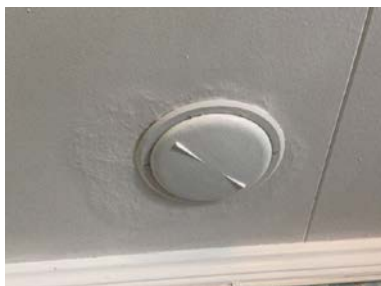
Svelling i himling ved ventil.
