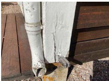
Råte i kleddningsbord rundt søyle.
