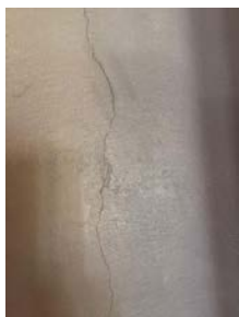
Sprekk i overflate på pipe i 2. etasje.
