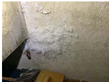
Eksempel på saltutslag.
