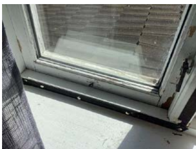
Eksempel på innvendig slitasje.
