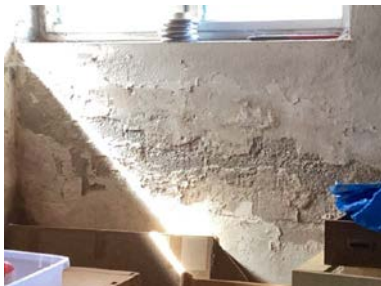
Eksempel på avskaling på vegger.
