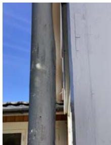
Eksempel på taknedløp med frostspreng.
