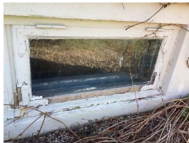
Eksempel på slitasje på kjellervindu.
