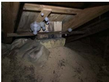
Rennemerker rundt gjennomføring for lufting på loft.
