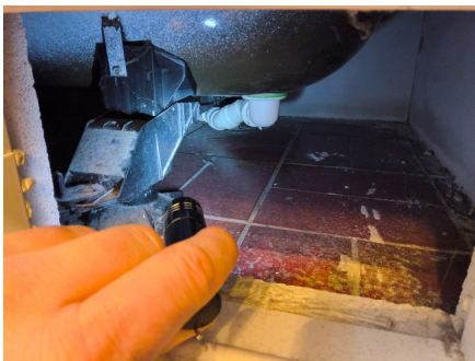
Øp fra badekar ført direkte ned i avløpsrør.
