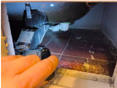
Øp fra badekar ført direkte ned i avløpsrør.
