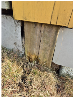
Råte i bunn av rekkverkskonstruksjon.
