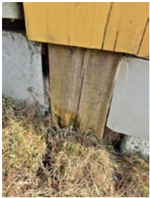
Råte i bunn av rekkverkskonstruksjon.
