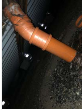
Bilde av lekkasje på/ved avløprør i krypkjeller
