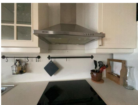
Montert avtrekk over komfyr.
