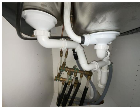
Del av rør til avløp.
