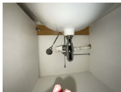
Del av rør til avløp.
