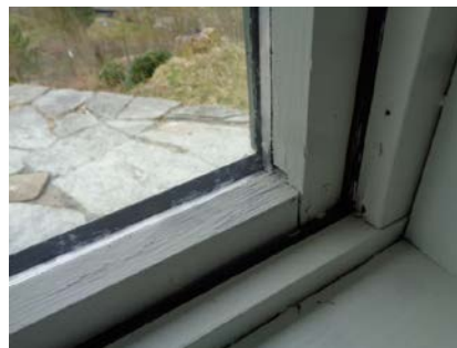
Noe slitt og oppsprekk i trekarmen og vinduer.
