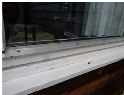
Noe værslitt utvendig.
