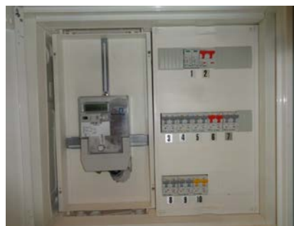
Sikringskap i entrè.
