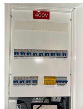
Sikringsskap med automatsikringer.
