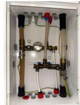
Samleskap med rørkurser og stoppekraner
