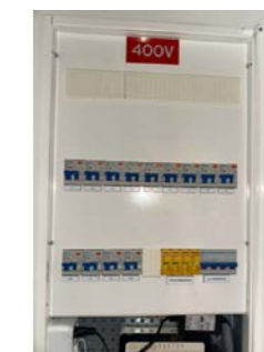
Sikringskap med automatsikringer.
