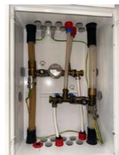
Samleskap med rørkurser og stoppekraner
