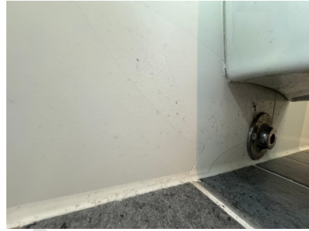
Sprekt flis bak toalett.
