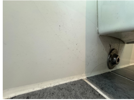
Sprekt flis bak toalett.
