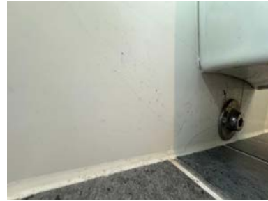
Sprekt flis bak toalett.
