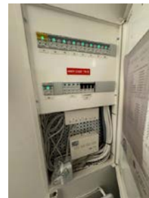
Sikringsskap med automatsikringer.
