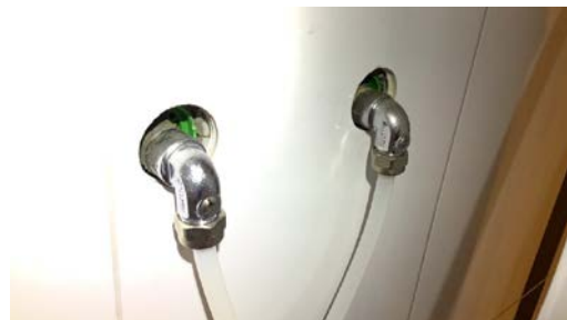
Det er ikke tettesjikt rundt rørgjennomføringer i vegg bak dusjkabinett.
