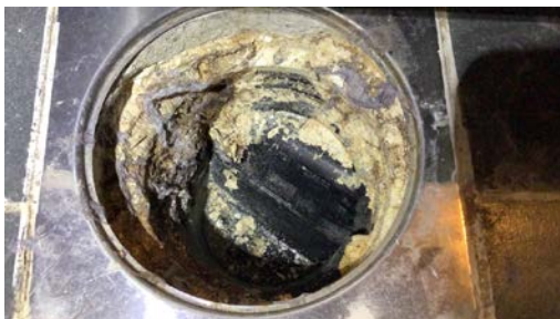
Plastsluk, uten synlig tettesjikt.
