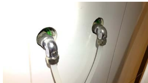
Det er ikke tettesjikt rundt rørgjennomføringer i vegg bak dusjkabinett.
