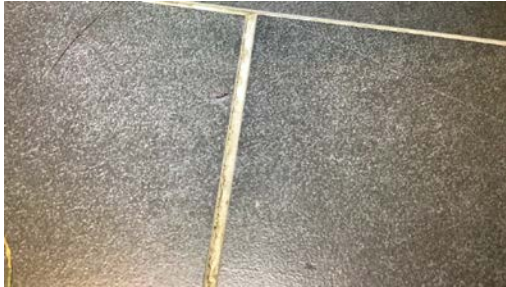
Eksempel på riss i flisfuge.
