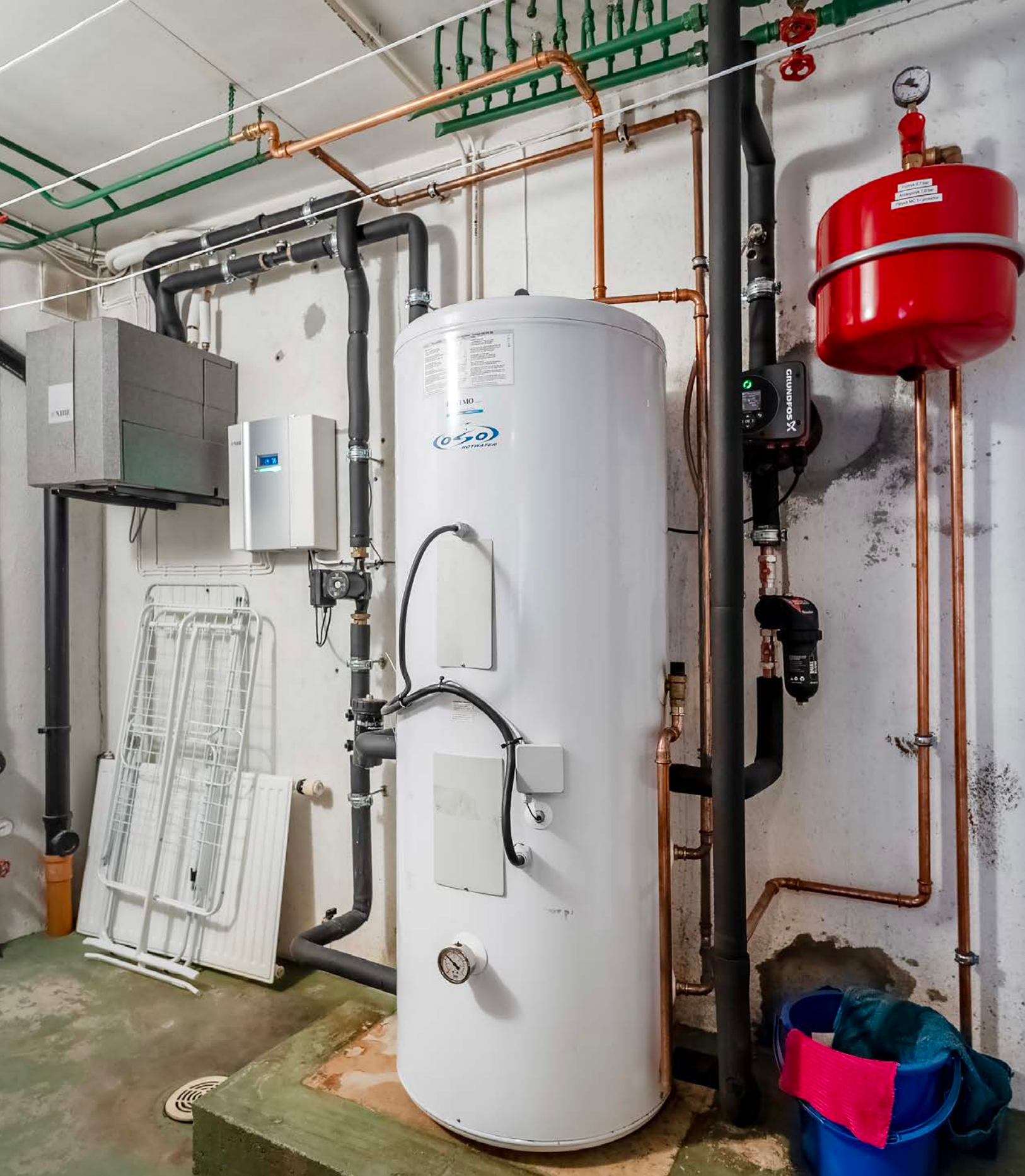
Teknisk rom med varmtvannsbereder, trykkutjevningstank, sirkulasjonspumper og innedel av varmepumpa. (Sokkeletasje)
