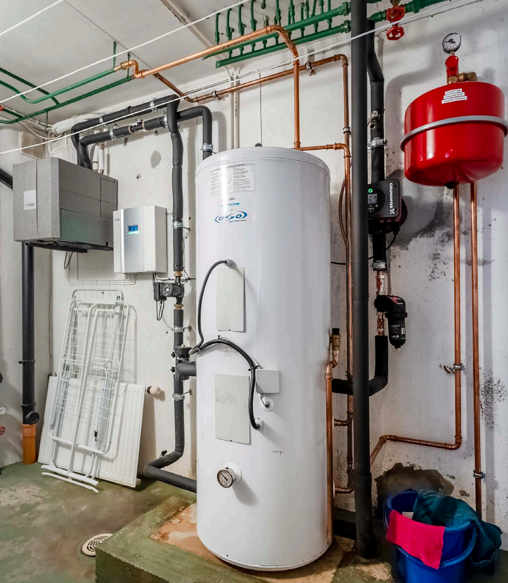
Teknisk rom med varmtvannsbereider, trykkutjevningstank, sirkulasjonspumper og innedel av varmepumpa. (Sokkeletasje)
