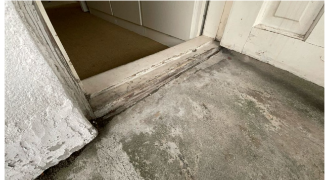
Overgang gulv og terskell uten synlig fuktsikring.
