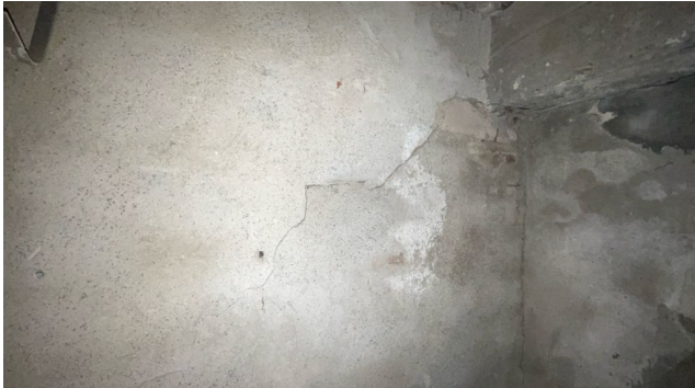
Skråriss i mur er observert i kjeller ved trapp.
