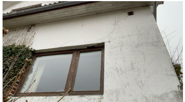
Det er observert sprekker i utvendige fasader.
