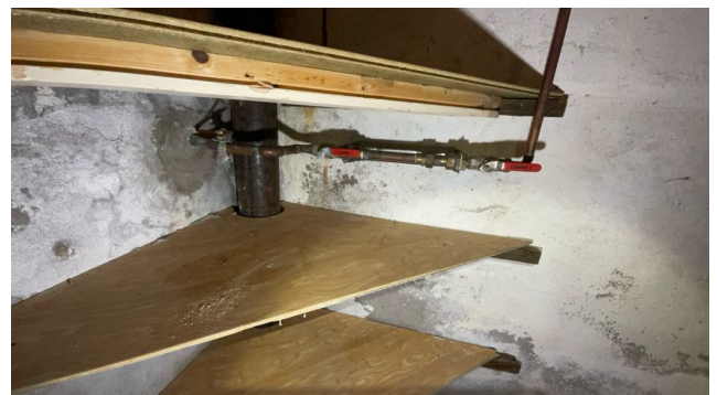
Hovedstoppekran er i bod i kjeller.
