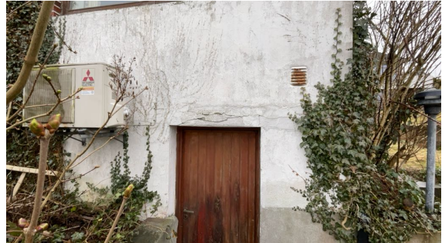
Det er observert sprekker i utvendige fasader.
