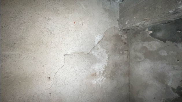
Vegg i kjeller ved trapp har skråriss som indikerer setninger i muren.
