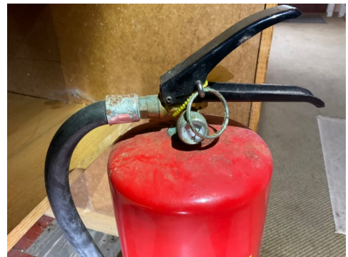
Boligen har brannslukningsapparat eldre. enn 10 år
