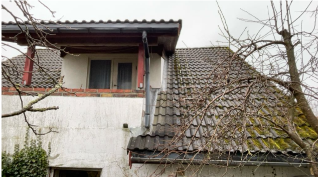
Tak har ikke snøfangere.
