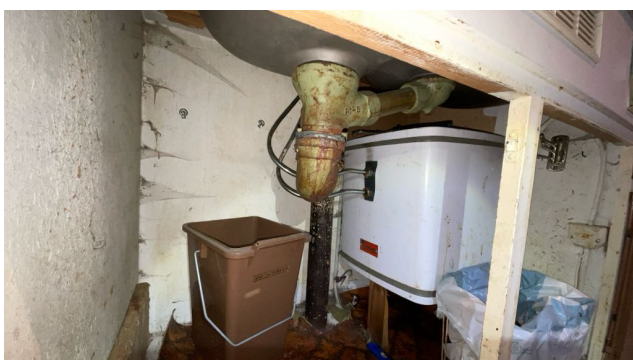
Avløpsrør på kjøkken.
