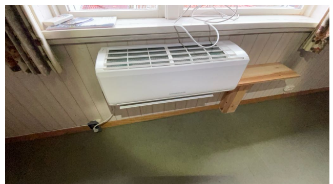
Innedel til varmepumpe er montert i stue
