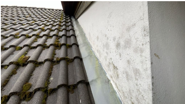
Nyere bly i overgang vegg og tak ved kvist
