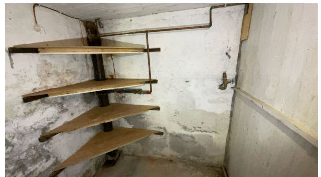
Hovedstoppekran er i bod i kjeller.
