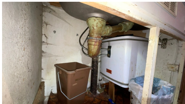
Varmtannstank på kjøkken.
