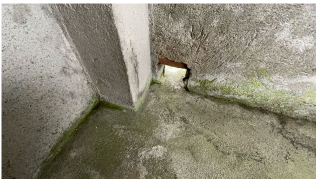
Hull i rekkverk for avrenning fra altan.
