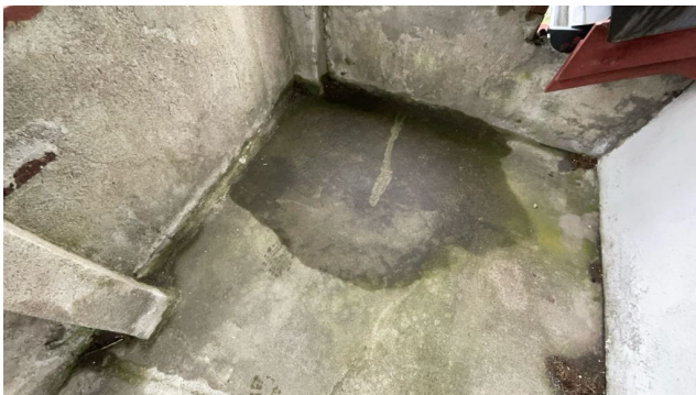
Ved regn kommer det vann inn på gulv til altan.
