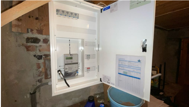
Boligen har sikringsskap med automatsikringer.
