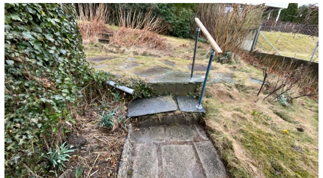
Utvendig trapp. Noen skiferheller er løse.
