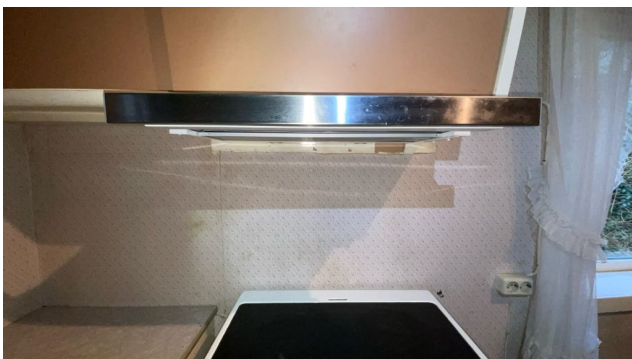
Kjøkken har ventilator montert i overskap med avtrekk ut.
