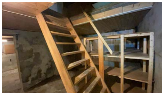
Trapp til kjeller. Det er ikke rekkverk på venstre side av trapp.
