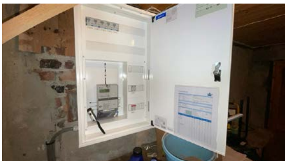
Boligen har sikringskap med automatsikringer.
