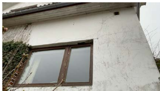
Det er observert sprekker i utvendige fasader.
