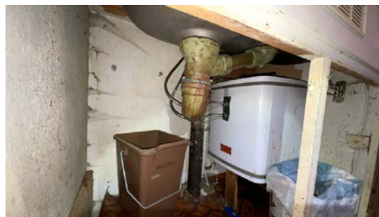
Varmtvannsbereider på kjøkken.
