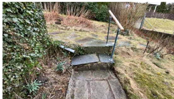
Utvendig trapp. Noen skiferheller er løse.
