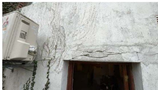
Over kjellerdør er det sprekker i mur og puss.
