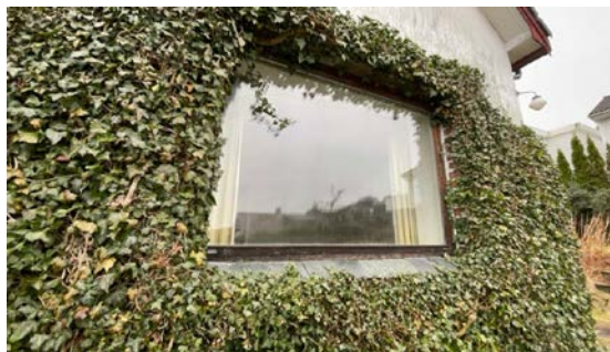
Vinduer har punkterte glass.
