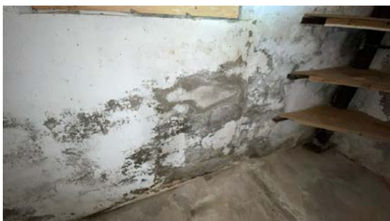
Det er saltutslag på vegg i bod, som indikerer fuktgjennomgang i mur.
