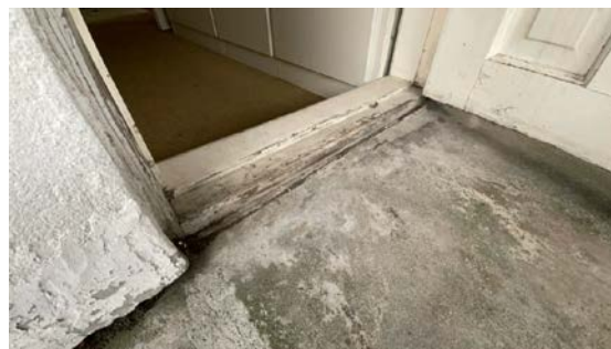
Overgang gulv og terskell uten synlig fuktsikring.
