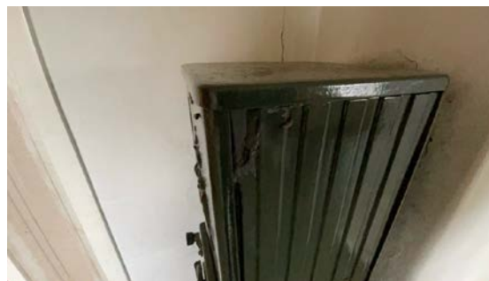
Ovn har sprekk og må byttes ut.
