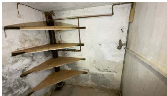
Hovedstoppekran er i bod i kjeller.
