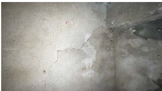
Vegg i kjeller ved trapp har skråriss som indikerer setninger i muren.
