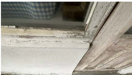
Vinduer har enkelt glass og fukt og råteskader.
