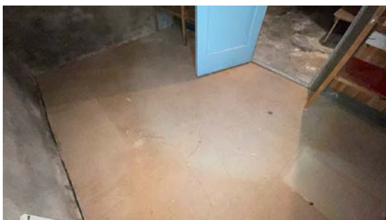
I bod er det oppført gulv med fare for fukt i konstruksjonen.
