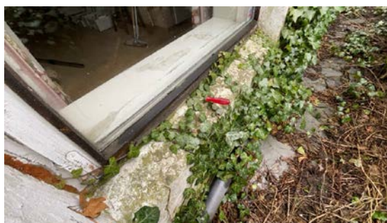
Vinduer har fukt og råteskader.
