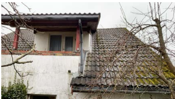
Tak har ikke snøfangere.
