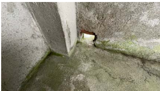
Hull i rekkverk for avrenning fra altan.
