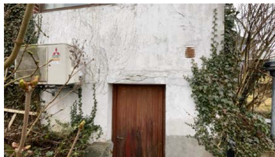
Det er observert sprekker i utvendige fasader.
