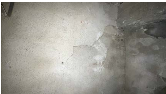
Skråriss i mur er observert i kjeller ved trapp.
