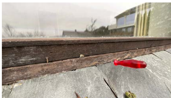
Vinduer har fukt og råteskader.
