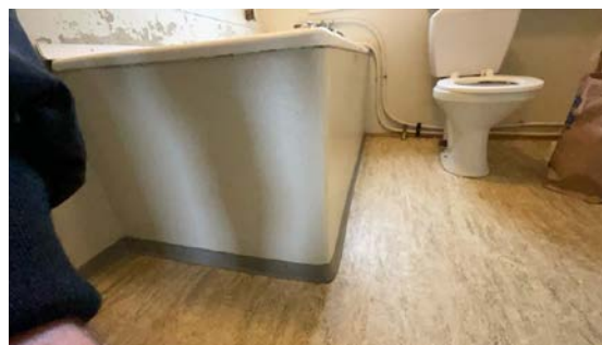
Bad har innebygget badekar uten inspeksjonsluke.
