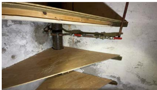
Hovedstoppekran er i bod i kjeller.
