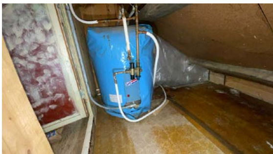
Varmtvannsbereider for bad er montert i kott ved bad i 2. etasje.
