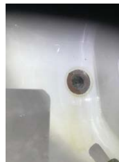
Vann renner tregt i vask på bad.
