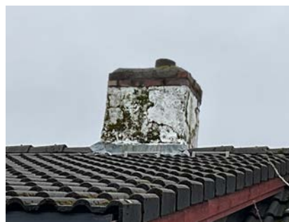
Utvendig er puss på pipen slitt med synlige sprekker i puss.
