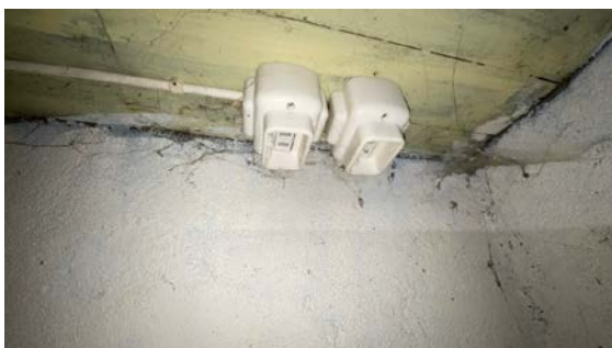
Koblinger for vaskemaskin og tørketrommel.
