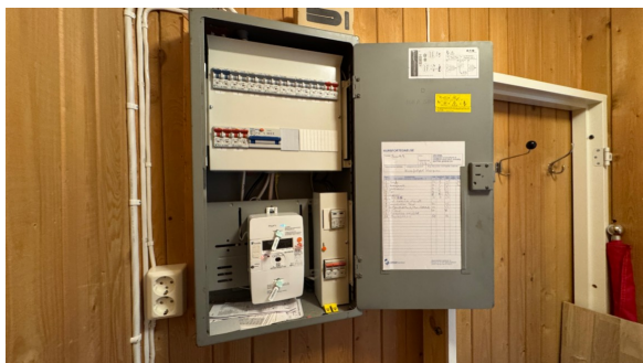
Kontroll av el-skap og kursfortegnelse.
