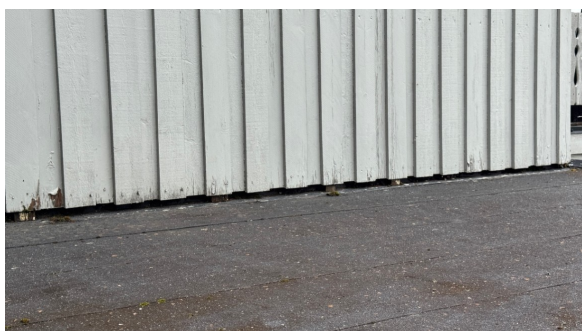
Det er påvist spredte råteskader i bordkledningen.
