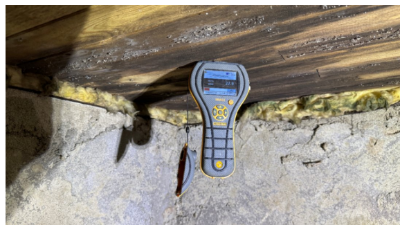
Det er målt forhøyede fuktverdier i stubbloftsbord.
