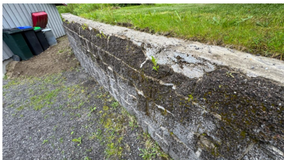
Støttemuren har noe skader/hakk.
