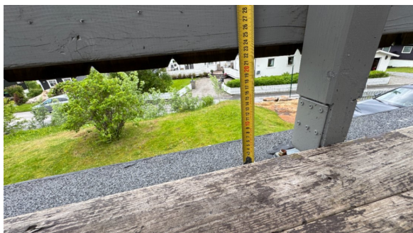
Åpninger i nedre kant på rekkverk for både terrasse og balkong er over 5 cm.
