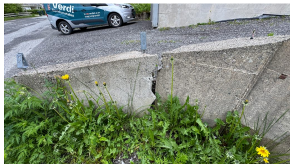
Det er påvist større sprekker i muren.
