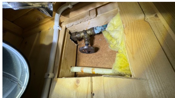
Det er irr på rør.
