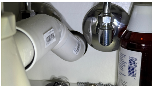
Det er påvist utette rørgjennomføringer i våtsone.
