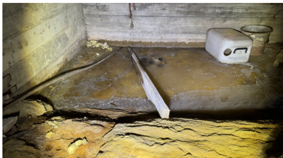
Det er påvist synlig vann i krypkjeller eller synlige tegn på innsig av vann i krypkjeller.
