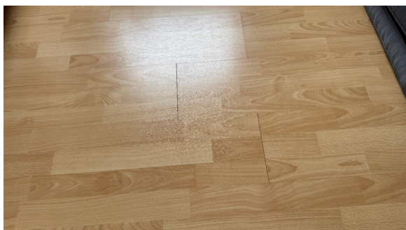
Det er registrert noe glipper i laminatskjøter.
