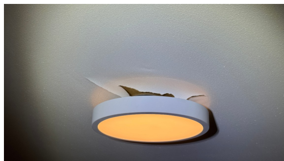
Sår i malerpapp bak taklampe på soverom.
