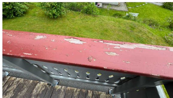
Rekkverk er værslitt.
