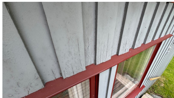
Det er påvist spredte råteskader i bordkledningen.
