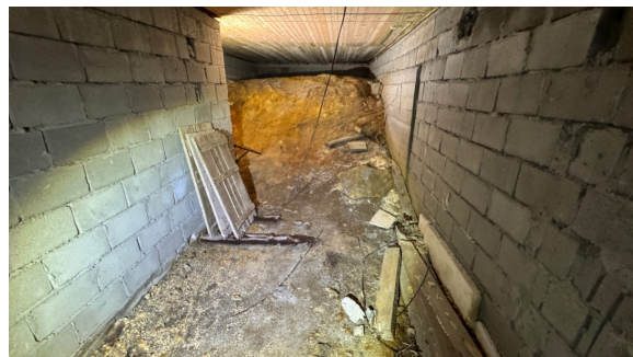
Det er manglende fuktsperre på bakken.
