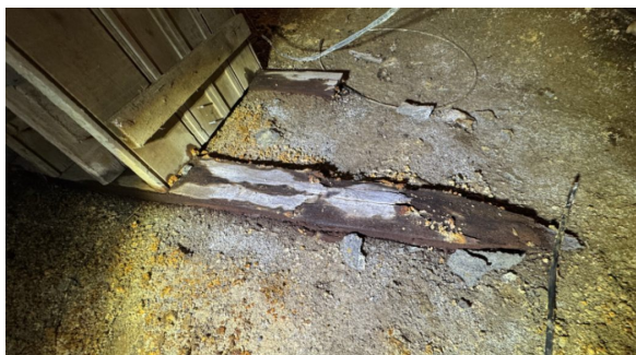
Organiske materialer lagret i krypkjeller er råteskadet.
