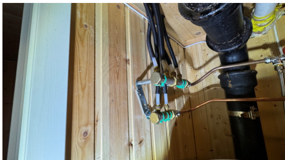
rørfordelerstokker er ikke plassert i et rørfordelerskap.
