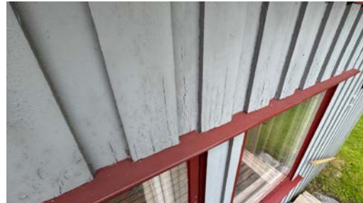
Det er påvist spredte råteskader i bordkledningen.
