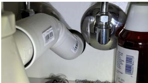
Det er påvist utette rørgjennomføringer i våtsone.
