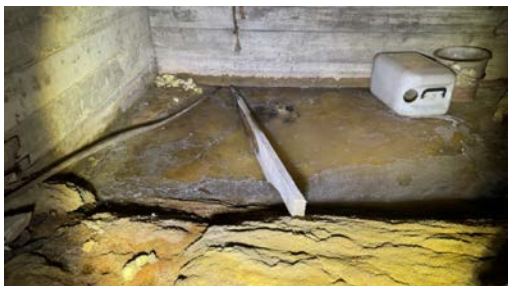
Det er påvist synlig vann i krypkjeller eller synlige tegn på innsig av vann i krypkjeller.
