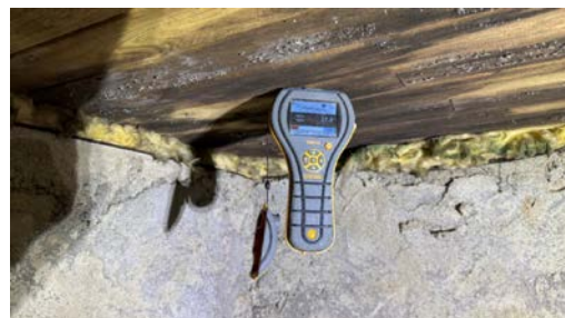
Det er målt forhøyede fuktverdier i stubbloftsbord.
