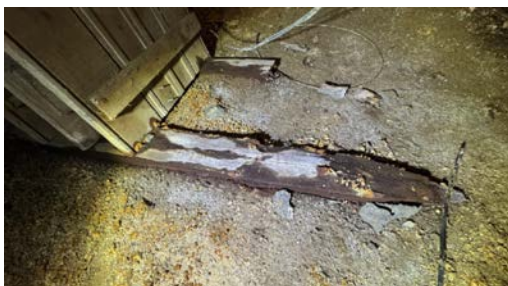
Organiske materialer lagret i krypkjeller er råteskadet.
