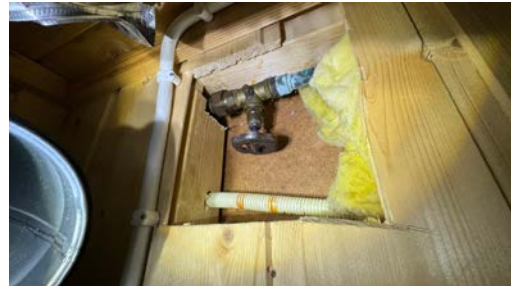
Det er irr på rør.
