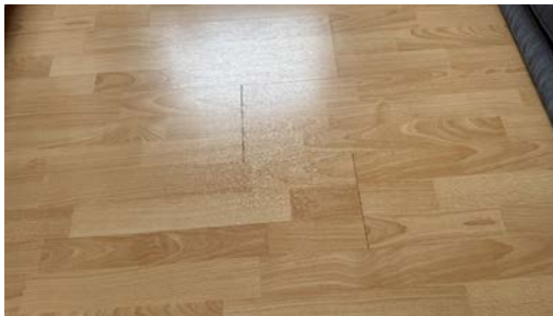
Det er registrert noe glipper i laminatskjøter.
