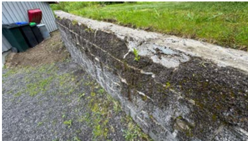
Støttemuren har noe skader/hakk.
