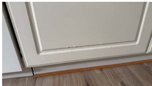
Innredningen har noe slitasje.
