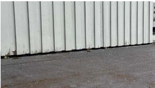
Det er påvist spredte råteskader i bordkledningen.
