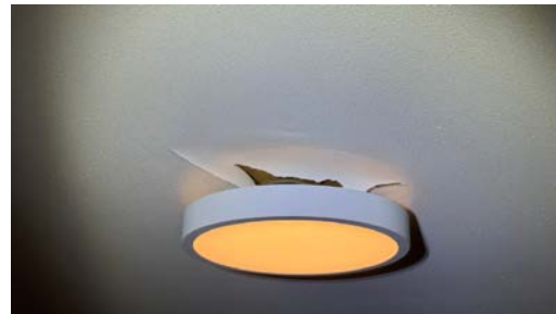
Sår i malerpapp bak taklampe på soverom.
