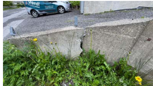
Det er påvist større sprekker i muren.
