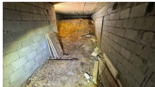
Det er manglende fuktsperre på bakken.
