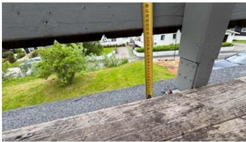
Åpninger i nedre kant på rekkverk for både terrasse og balkong er over 5 cm. Rekkverk er værslitt.
