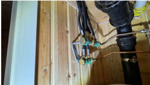
rørfordelerstokker er ikke plassert i et rørfordelerskap.
