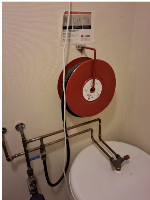
Husbrannslange er plassert på bod/teknisk rom.
