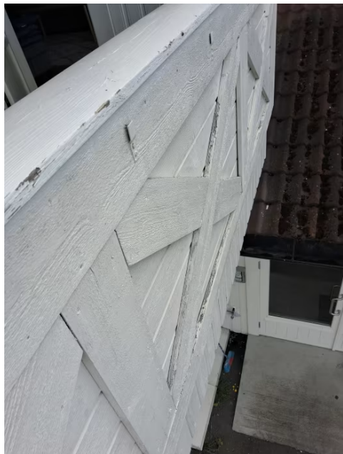
Rekkverk er malingsslitt.
