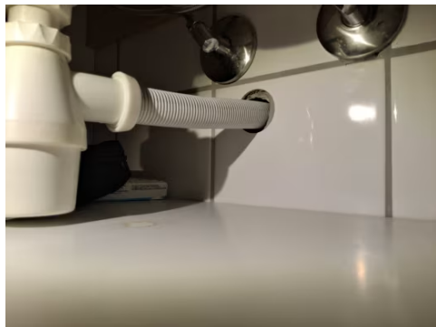
Avløpsrør med motfall på registreres under servant på bad.
