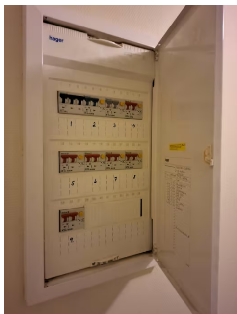
Sikringsskap er plassert i bod/teknisk rom.
