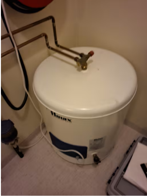
Varmtvannsbereder er plassert på bod/teknisk rom.
