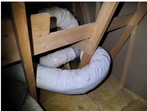
Mekanisk avtrekksvifte er plassert på kaldtloft.
