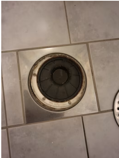
Det ble ikke registrert avvik på sluk.
