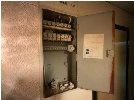
Sikringskap i underetasjen.
