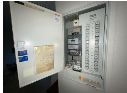
Sikringskap i første etasje
