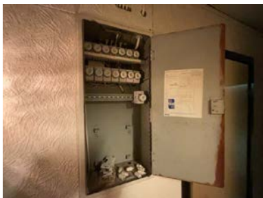
Sikringsskap i underetasjen.
