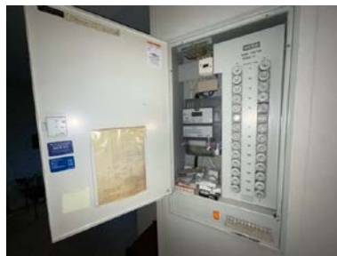
Sikringsskap i første etasje
