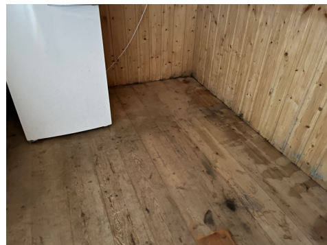
Synlig råte i kjeller
