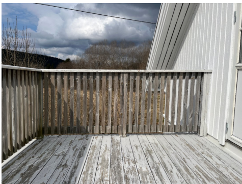
Værslitt gulv, synlig skjevhet i balkong
