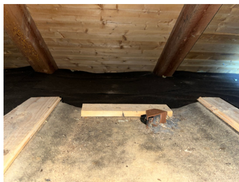
Ukjent luftespalte i skrå isolert tak.
