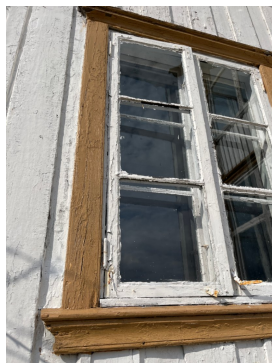
Værslitt, vindu går ikke å lukke.
