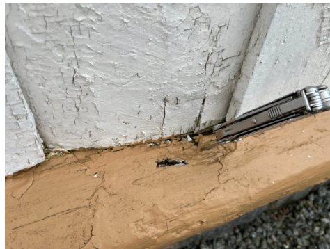
Råte i vannbrett nederst
