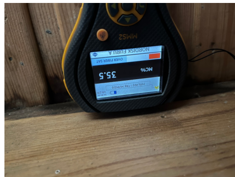
Høy fuktighet, vått i treverk
