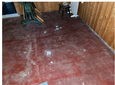
Manglende membran på gulv/vegger
