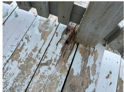
Råteskade i gulv på trapp
