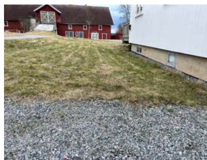
Terrengfall mot grunnmur østvegg
