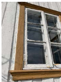
Værslitt, vindu går ikke å lukke.
