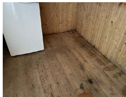
Synlig råte i kjeller
