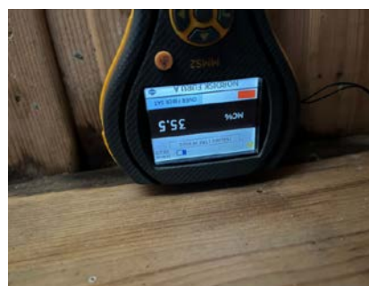
Høy fuktighet, vått i treverk
