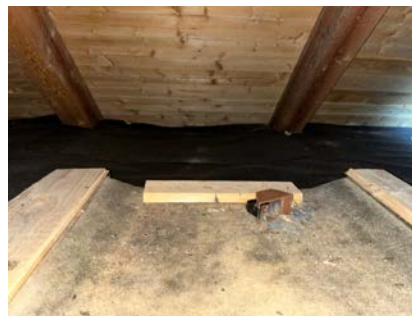
Ukjent luftespalte i skrå isolert tak.
