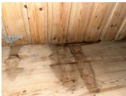
Fukt inn i kjeller.
