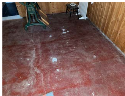
Manglende membran på gulv/vegger
