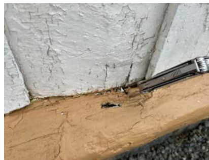
Råte i vannbrett nederst
