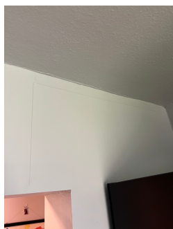
Riss i overgang tak/himling på kjøkken
