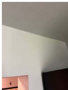
Riss i overgang tak/himling på kjøkken
