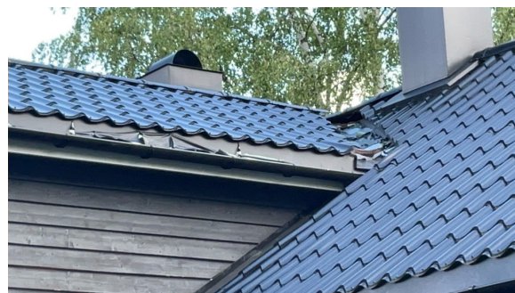
Avskalling på renner registrert
