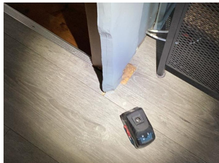
Manglende håndverksmessig utførelse på deler av arbeid.
