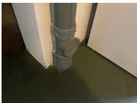
Stakeluke på teknisk rom.
