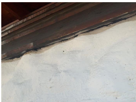
Ingen lufting av kledning.
