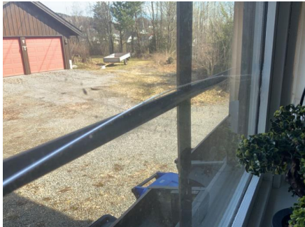
Sprukket vindu på soverom i 1. etasje.
