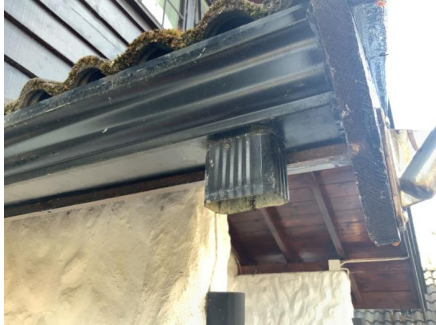
Mangler nedløp fra takrenne på garasjedel.
