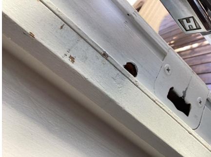
Sprukket tettelist på terrassedør i 1. etasje.
