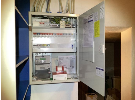
Sikringskap lokalisert på teknisk rom.
