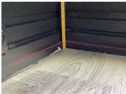
Helningsavvik på 19 mm ble målt på soverom mot sør/øst i loftsetasje.
