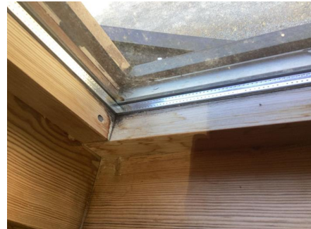
Kondensmerker på enkelte vinduer.
