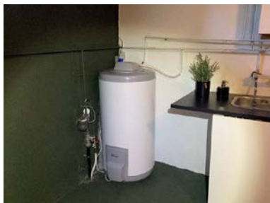
Varmtvannsbereider lokalisert teknisk rom.
