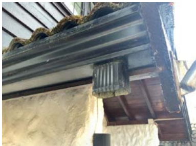
Mangler nedløp fra takrenne på garasjedel.
