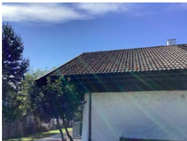
Selgers opplysning: Mose er sprøytet og skal bli borte ved nedbør.
