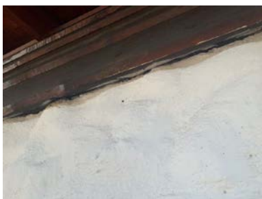
Ingen lufting av kledning.
