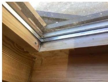
Kondensmerker på enkelte vinduer.
