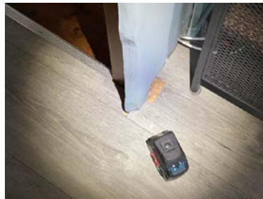
Manglende håndverksmessig utførelse på deler av arbeid.
