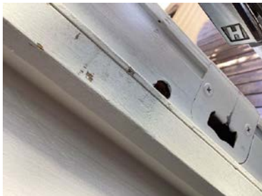
Sprukket tetteliste på terrassedør i 1. etasje.
