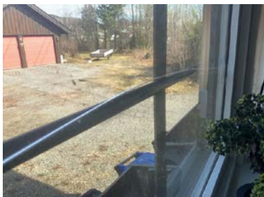
Sprukket vindu på soverom i 1. etasje.
