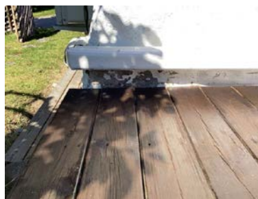
Malingsflass på vegg.
