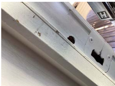
Sprukket tettelst på terrassedør i 1. etasje.
