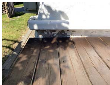
Malingsflass på vegg.
