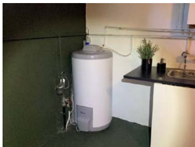
Varmtvannsbereder lokalisert teknisk rom.
