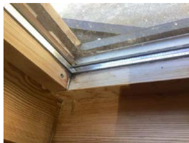
Kondensmerker på enkelte vinduer.
