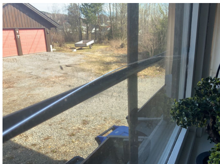
Sprukket vindu på soverom i 1. etasje.
