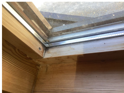
Kondensmerker på enkelte vinduer.
