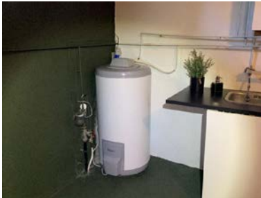
Varmtvannsbereider lokalisert teknisk rom.
