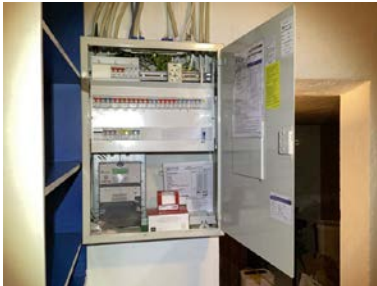
Sikringsskap lokalisert på teknisk rom.
