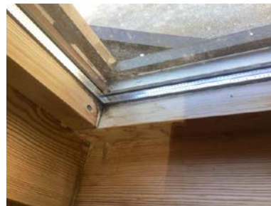
Kondensmerker på enkelte vinduer.
