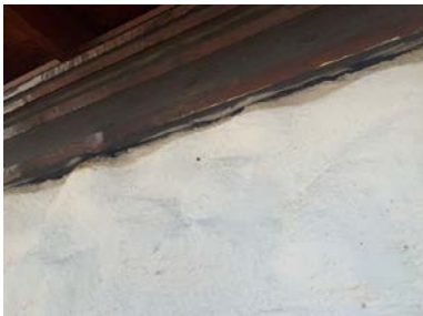
Ingen lufting av kledning.
