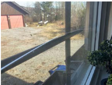
Sprukket vindu på soverom i 1. etasje.
