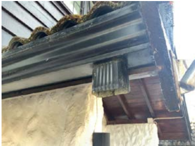
Mangler nedløp fra takrenne på garasjedel.
