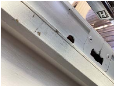
Sprukket tettelst på terrassedør i 1. etasje.
