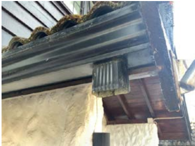
Mangler nedløp fra takrenne på garasjedel.
