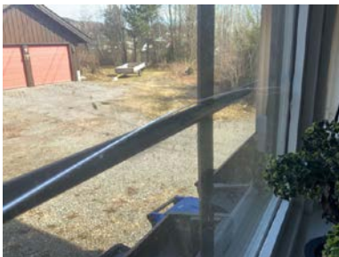
Sprukket vindu på soverom i 1. etasje.
