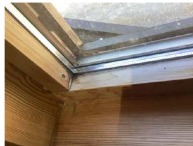
Kondensmerker på enkelte vinduer.
