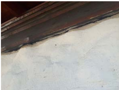
Ingen lufting av kledning.
