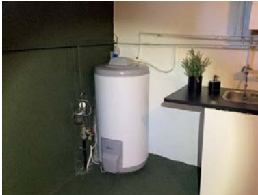
Varmtvannsbereider lokalisert teknisk rom.
