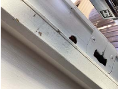
Sprukket tetteliste på terrassedør i 1. etasje.
