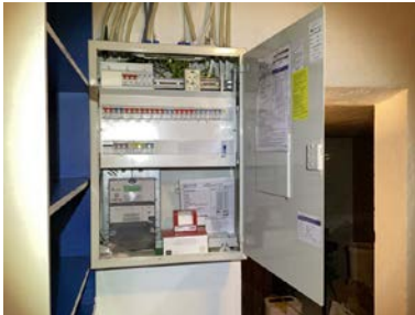
Sikringsskap lokalisert på teknisk rom.
