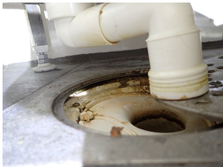
Plastsluk under dusjkabinett.
