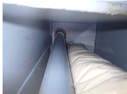
Utettheter i luftelyre / kloakklufting.
