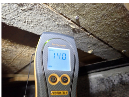
Ingen skadelig fukt målt i etasjeskille på kontrollert sted
