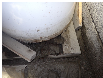
Råte i understøttelse til bereder.
