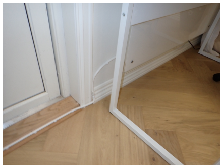
Ufagmessig kabelføring ført foran balkongdør til panelovn.
