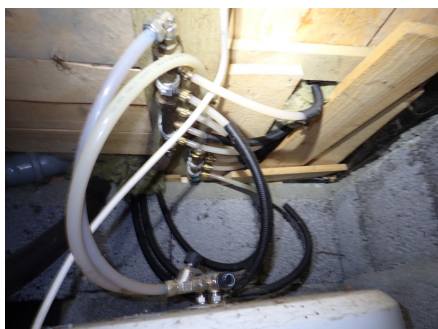
Uisolerte vannrør i krypkjeller.
