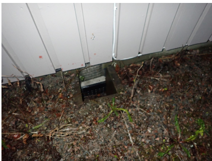
Ventil i grunnmur, utsatt for overflatevann.
