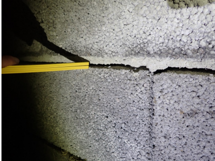
Horisontal sprekk i murfuger mellom lecastein.
