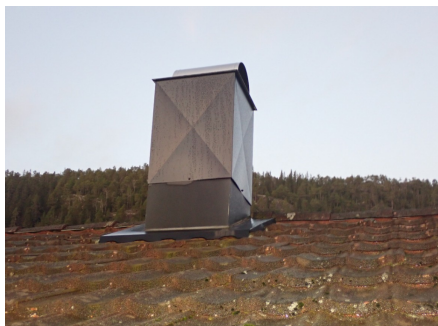
Mosevekst på taktekkning.
