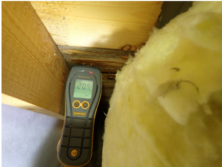
Det måles fuktig treverk / undertak med takgjennomføring.
