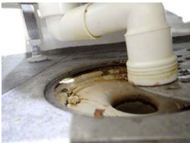
Plastsluk under dusjkabinett.
