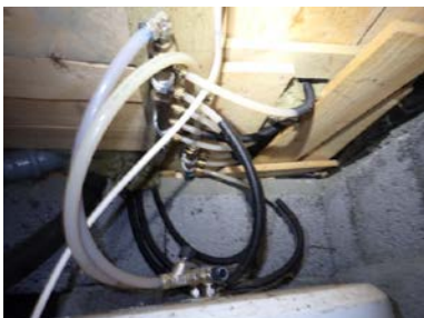
Uisolerte vannrør i krypkjeller.
