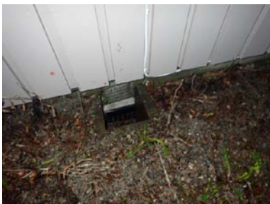
Ventil i grunnmur, utsatt for overflatevann.
