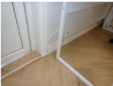
Ufagmessig kabelføring ført foran balkongdør til panelovn.
