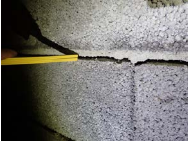
Horizontal sprekk i murfuger mellom lecastein.
