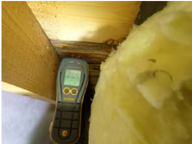
Det måles fuktig treverk / undertak med takgjennomføring.
