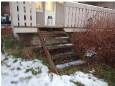
Det mangler rekkverk i trapp der avstand ned til terrenget er større enn 50 cm
