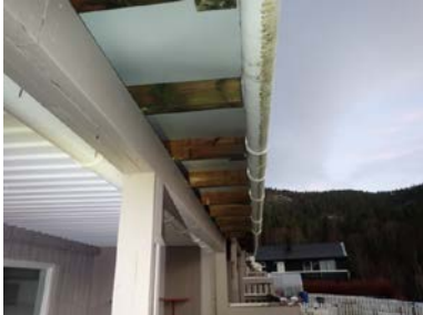
Utettheter i metallplater / avrenning fra balkong.
