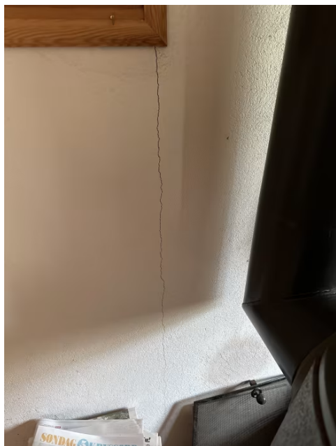
Det registreres sprekker/ riss i pipa.
