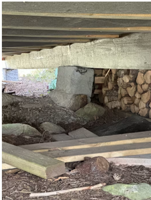
Det registreres skjevheter ved fundamenter.
