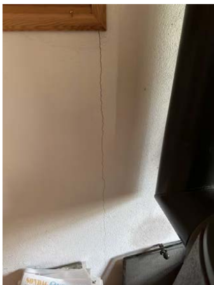
Det registreres sprekker/ riss i pipa.
