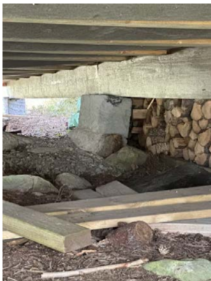
Det registreres skjevheter ved fundamenter.
