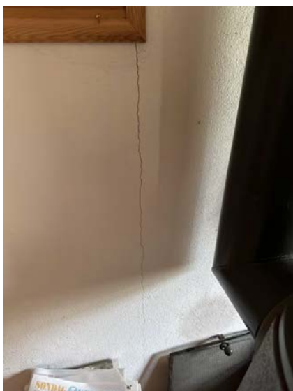
Det registreres sprekker/ riss i pipa.
