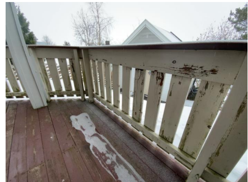
Synlige råteskadet trevirke.
