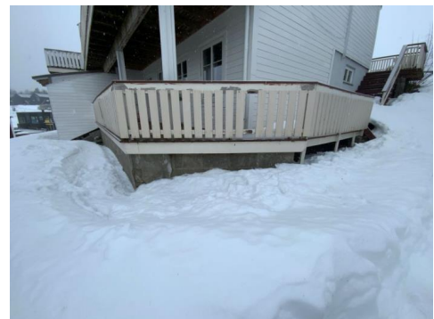
Synlig riss i fundament.
