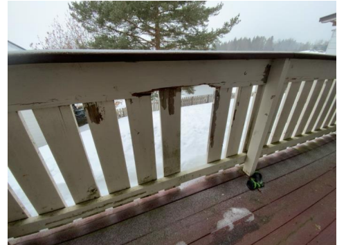
Synlige råteskadet trevirke.
