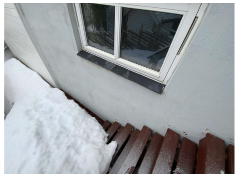
Synlige riss i murpuss der utbedringer er påregnelig.
