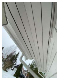
Synlige luftespalter i gesimskasser.
