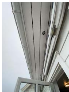
Synlige luftespalter i gesimskasser.
