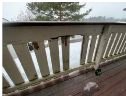
Synlige råteskadet trevirke.
