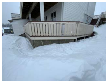
Synlig riss i fundament.
