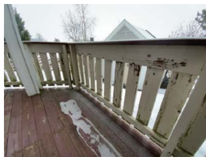
Synlige råteskadet trevirke.
