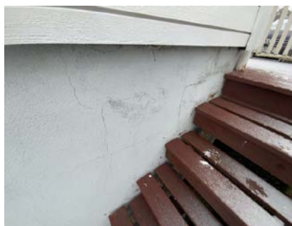
Synlige riss i murpuss der utbedringer er påregnelig.
