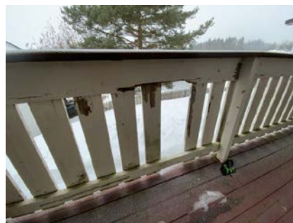
Synlige råteskadet trevirke.
