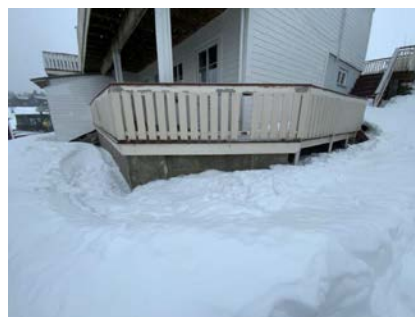
Synlig riss i fundament.
