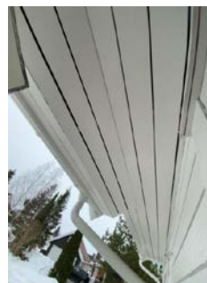
Synlige luftespalter i gesimskasser.
