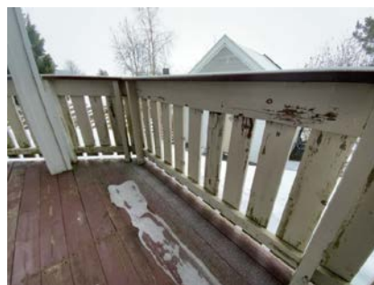
Synlige råteskadet trevirke.
