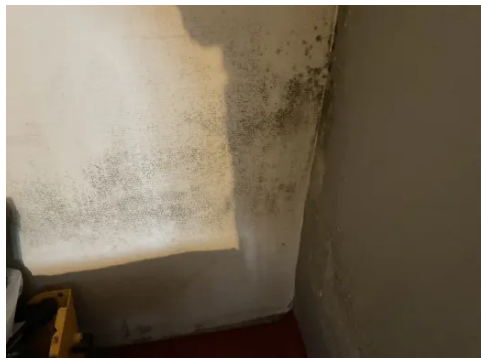
Synlig svertesopp på betongoverflater på soverom.
