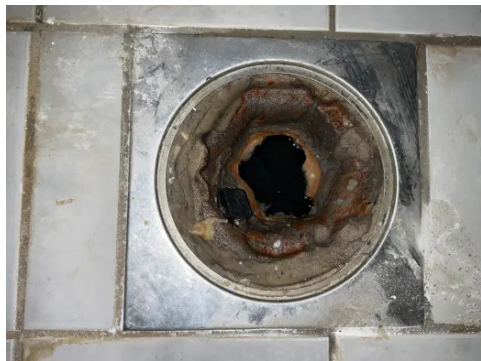
Eldre støpejernsluk uten klemring for god tetting
