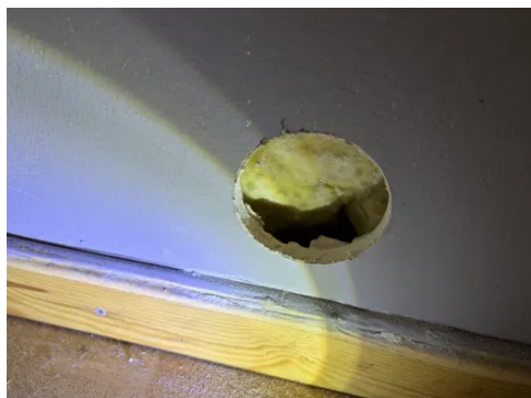
Undersøkelsen er noe begrenset da bunnsvill er i stål.
