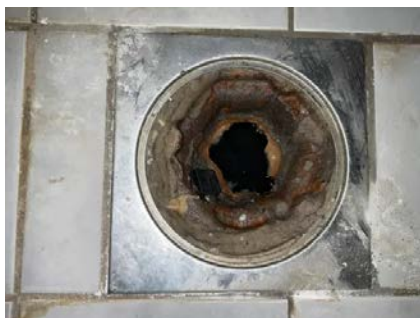
Eldre støpejernsluk uten klemring for god tetting
