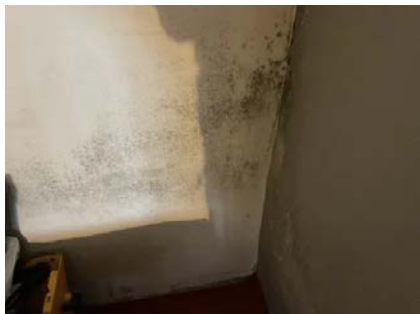
Synlig svertesopp på betongoverflater på soverom.
